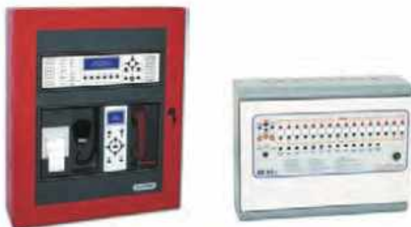
شکل ۱۲ - تابلوی کنترل متعارف و آدرس پذیر
